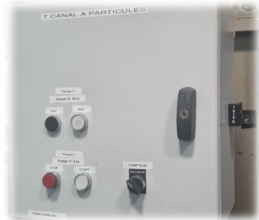
Figure 6 : armoire de commande des pompes
